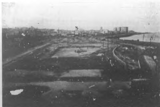
Una vista de las obras de construcción del Parque "Maceo", a los pocos días de iniciarse.
